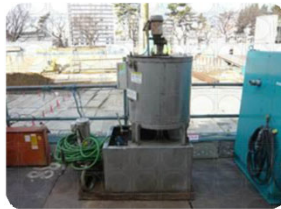
消泡剤調整槽
